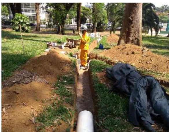
Figura 71: Drenagem Próximo ao P8
