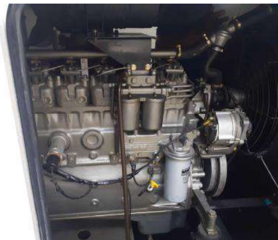
Figura 88: Gerador do Auditório
