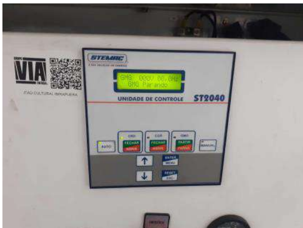
Figura 87: Gerador do Auditório
